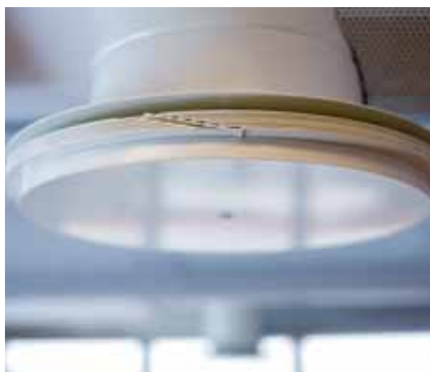
1. Från våra apparatrum regleras inneklimatet. 2. Luftdonen justeras automatiskt beroende på omgivningen.
